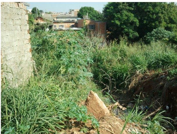
Foto 07: Vista do talvegue erodido.
