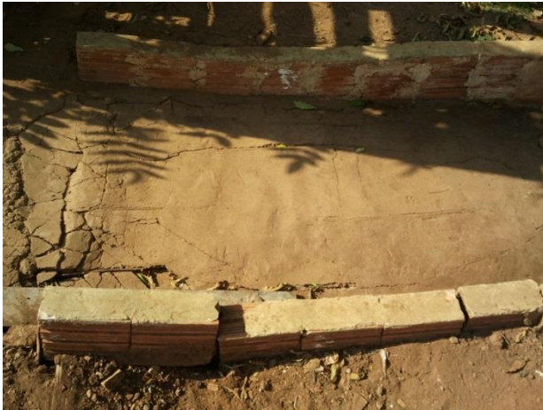
Foto 09: Detalhe da calçada construída por morador que esta afundando indicando instabilidade.
