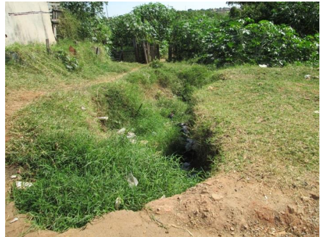
Foto 06: Detalhe de outra ravina à margem do córrego.
