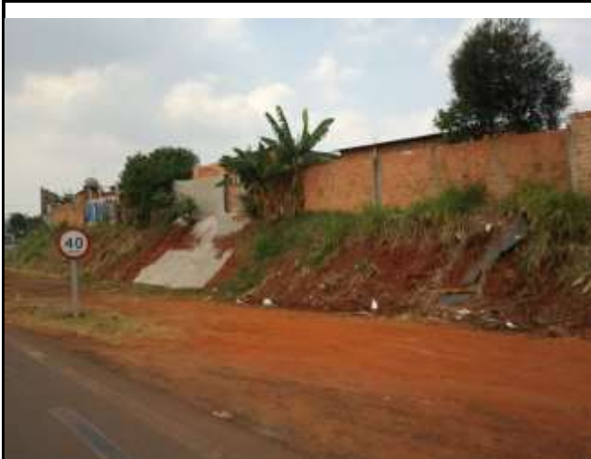
Foto 03: Talude marginal a rodovia, pequeno trecho com cimento jateado realizado por moradores para proteger o talude.
