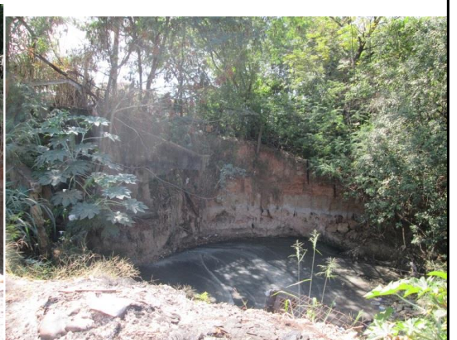
Foto 06: Imensa erosão causada pela drenagem da avenida no afluente do Ribeirão Quilombo.
