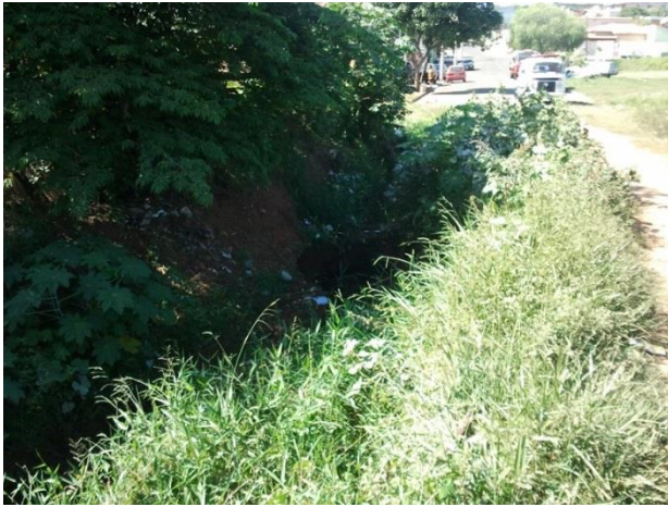
Foto 03: Drenagem subdimensionada provoca a erosão marginal no córrego
