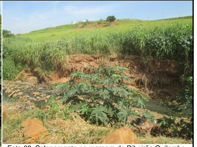
Foto 02: Solapamento na margem do Ribeirão Quilombo.
