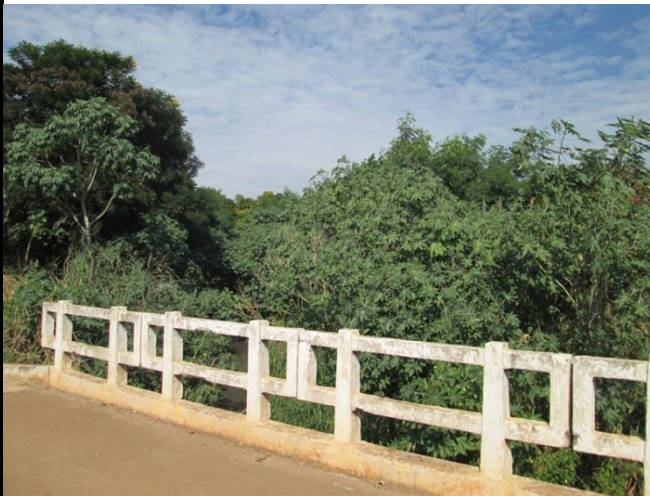
Foto 01: Vista da ponte na Av. João Argenton, pode-se visualizar marca d'água nesta indício de inundações e enchentes.
