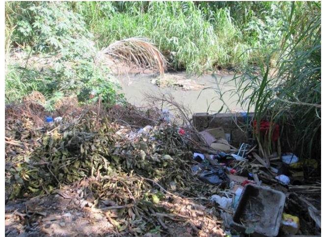
Foto 04: Detalhe da margem com lixo e entulho, assoreamento e pequeno muro de contenção.
