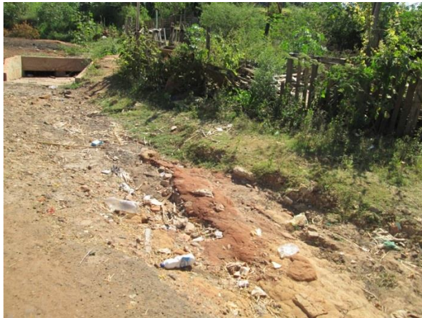
Foto 01: Vista dos sulcos erosivos e drenagem ao fundo nas proximidades do córrego.
