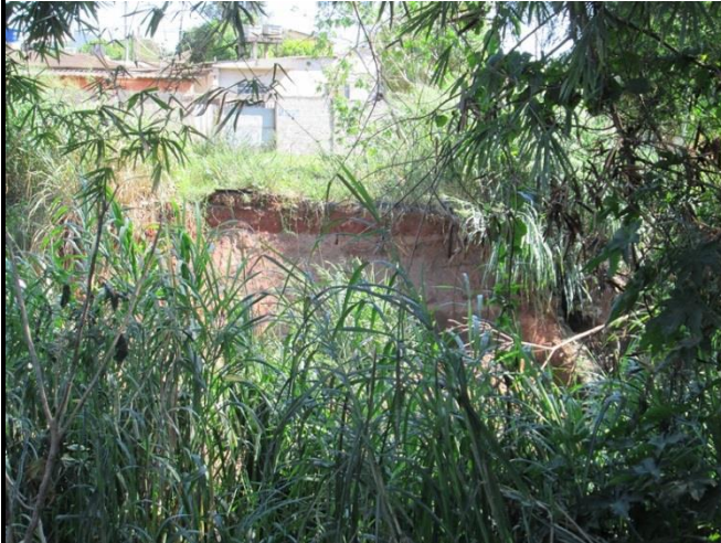
Foto 03: Solapamento e processo erosivo em estágio avançado na margem direita do córrego
