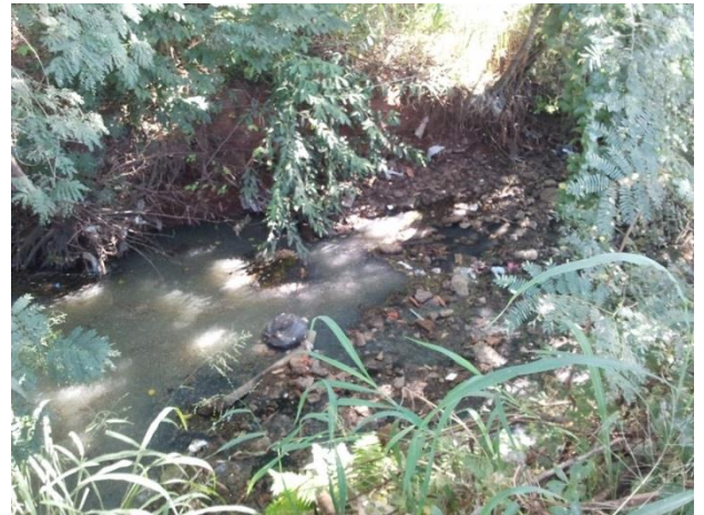
Foto 12: Erosão e assoreamento do córrego.
