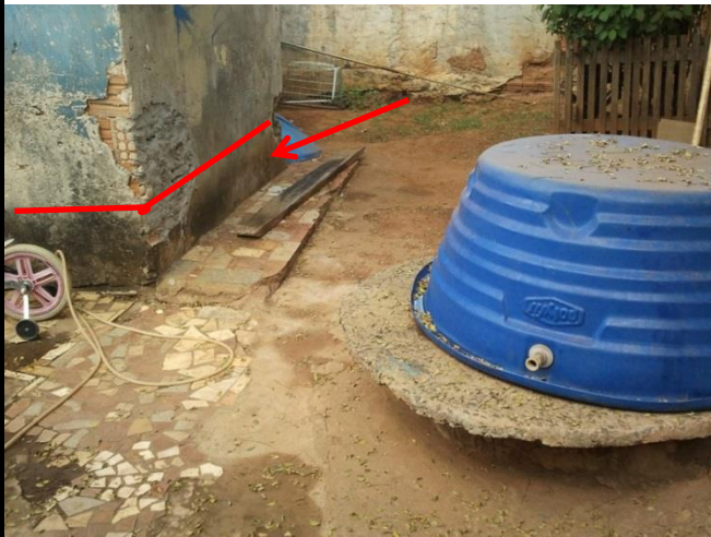
Foto 03: Na parede da residência evidencia-se marca d'água proveniente dos alagamentos
