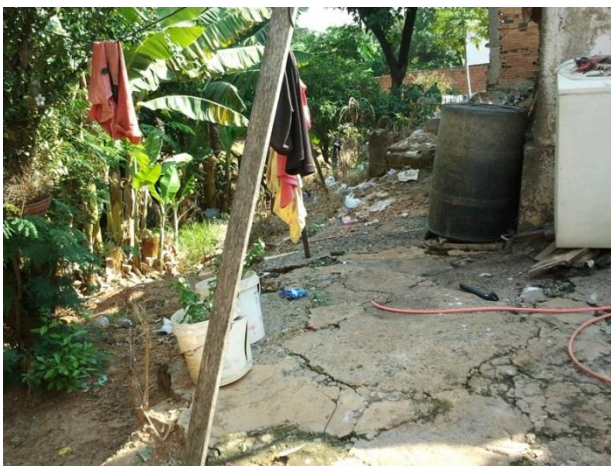
Foto 09: Detalhe de trincas no solo de terreno marginal ao córrego
