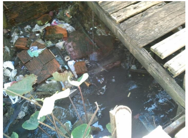
Foto 10: Lixo e entulho no leito do curso d'água.
