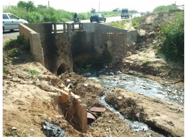
Foto 03: Detalhes da drenagem urbana obstruída com lixo e entulho.
