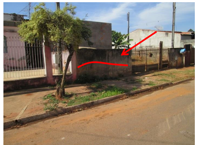
Foto 08: Residências atingidas pela inundação observam-se marca d'água no muro.
