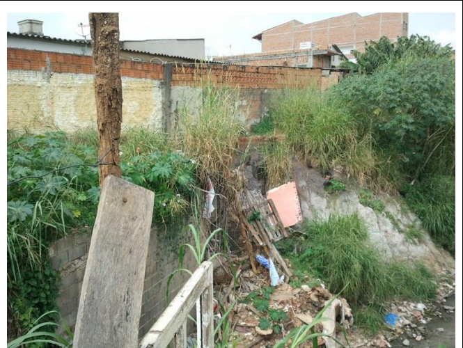
Foto 04: Detalhe das construções e do talude marginal que apresenta processo erosivo.
