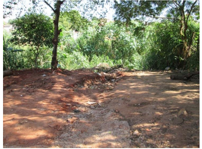
Foto 02: Vista da erosão na margem direita do Córrego Tijuco Preto, solo exposto e pouca vegetação.
