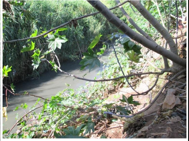
Foto 02: Montante do córrego evidencia-se solapamento da margem.
