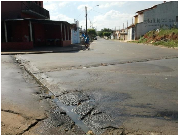
Foto 03: Detalhe da drenagem urbana inadequada
