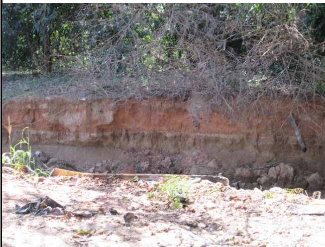
Foto 05: Erosão marginal no afluente do Ribeirão Quilombo
