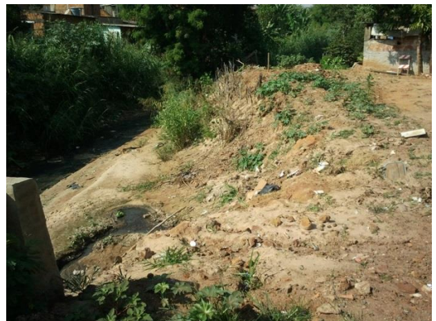
Foto 05: Erosão na margem direita.
