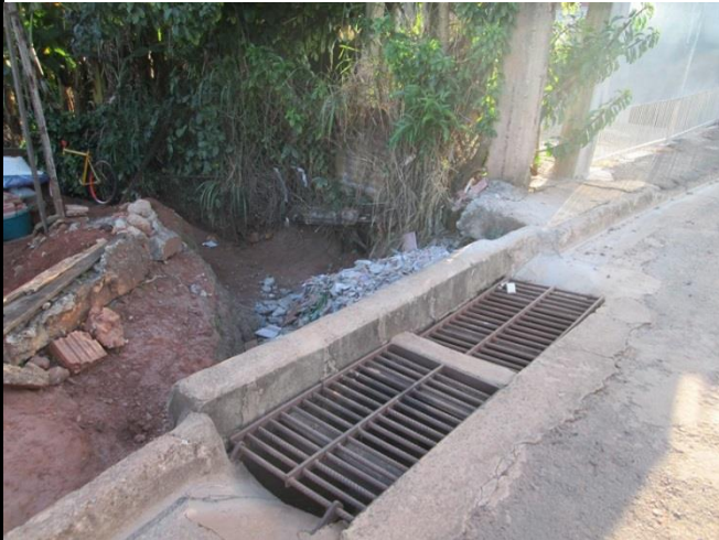
Foto 03: Vista da drenagem na rua e sulcos erosivos causados pela velocidade da água indicando que a drenagem é subdimensionada.
