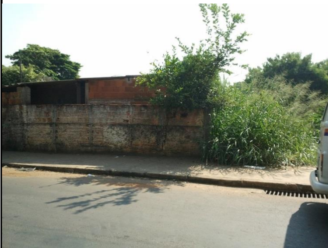
Foto 03: Vista de muro trincado da benfeitoria indicando instabilidade na margem do córrego.
