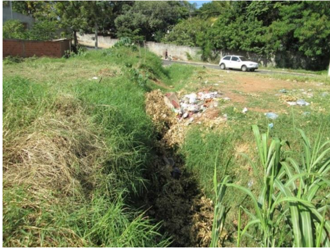
Foto 01: Drenagem improvisada que liga o fluxo de água da rua até o córrego, e utilizada como depósito de lixo.
