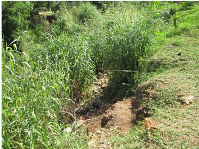
Foto 03: Solapamento de trecho da margem direita do córrego.
