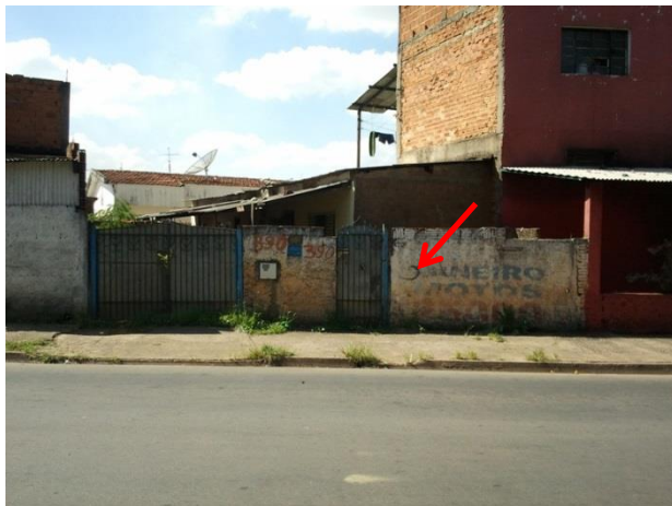
Foto 01: Vista da rua marca d'água nos muros devido a inundações.
