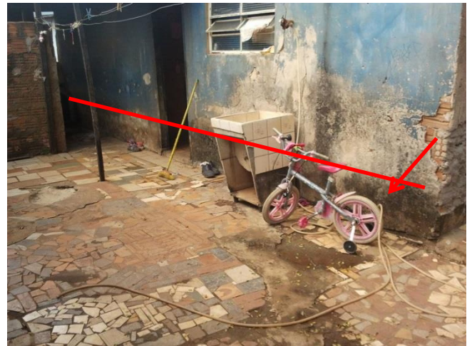
Foto 04: Vista da residência atingida e marca d'água na parede.
