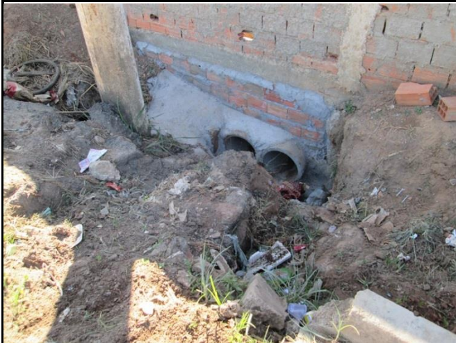
Foto 07: Detalhe da erosão em bueiro improvisado pelos moradores.
