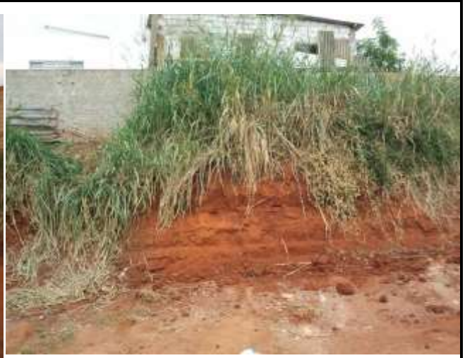
Foto 04: Detalhe de escavação irregular no talude comprometendo as moradias a cima.
