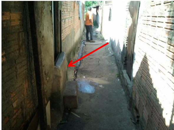
Foto 01: Viela na invasão nota-se a altura da contenção construída pelos moradores nas portas para a água não invadir a residência.
