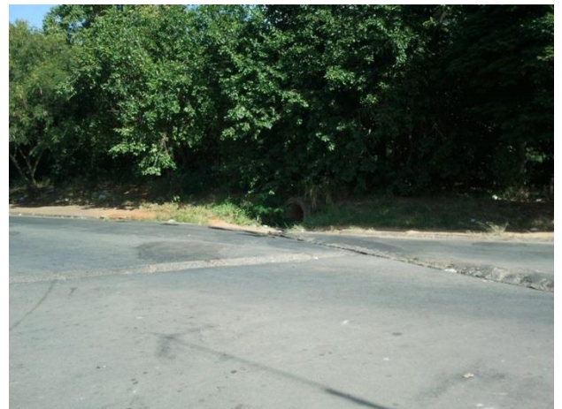
Foto 02: Drenagem urbana não adequada e subdimensionada.
