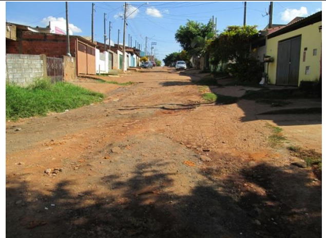
Foto 08: Sulcos erosivos na parte superior da rua causado pela falta de drenagem.
