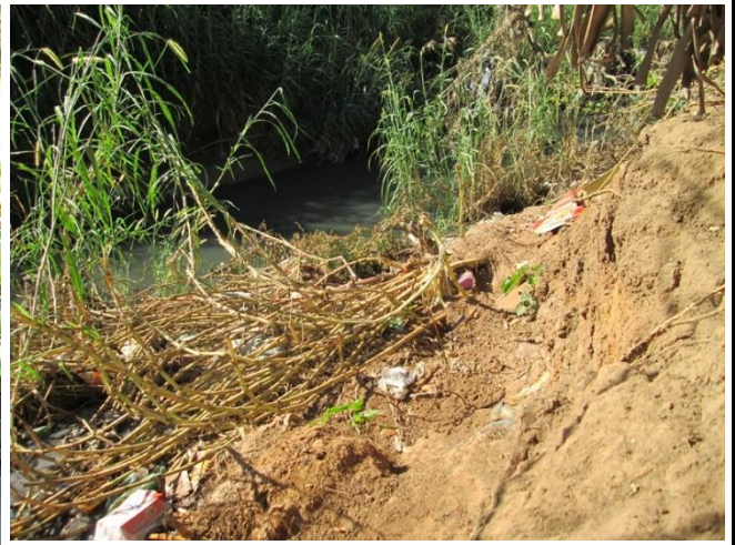
Foto 04: Detalhes do solapamento na margem do córrego.
