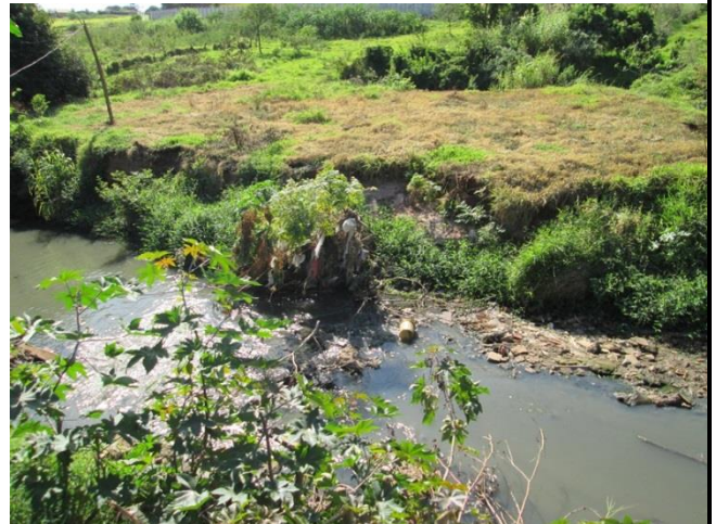
Foto 04: Vista da margem direita à jusante do córrego, processo erosivo e assoreamento do leito.
