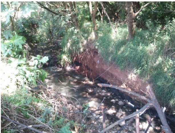
Foto 07: Erosão marginal provocando solapamento na margem esquerda do córrego
