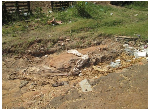
Foto 02: Detalhe da erosão na rua.
