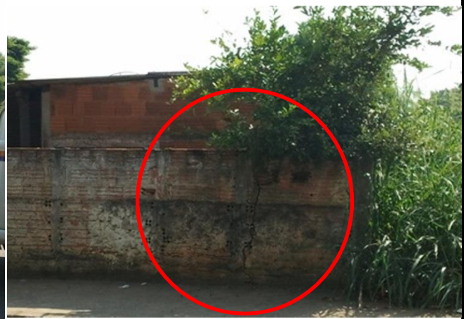
Foto 04: Detalhe da trinca no muro, da edificação adjacente ao córrego.
