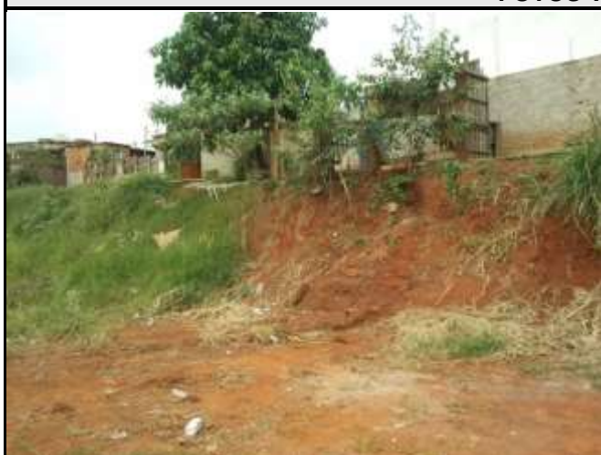
Foto 01: Vista do talude, cicatriz de escorregamento.
