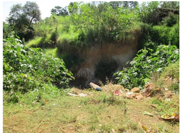
Foto 04: Talude marginal do córrego erodido.
